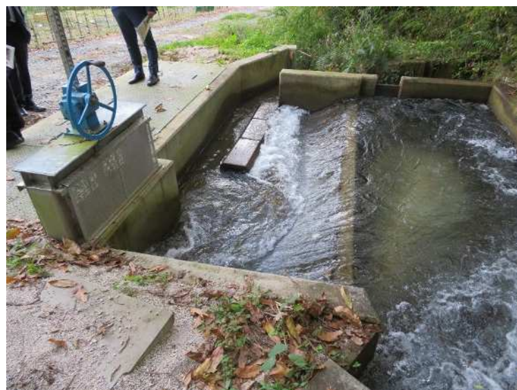
発電施設へ給水する除塵構造を有する取水施設
