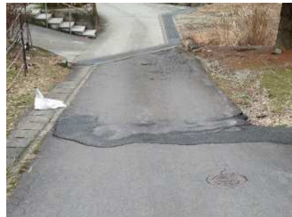
◎村道陥没、側溝劣化（洞川）
