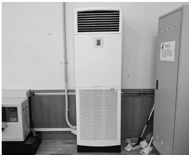
▲ランチルーム空調遠景とランチルーム空調
