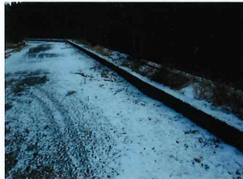
②場内花壇付近の沈下
