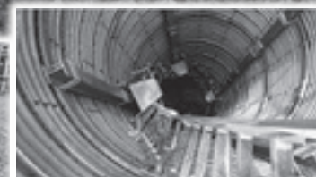
地下水を排出するための集水井
